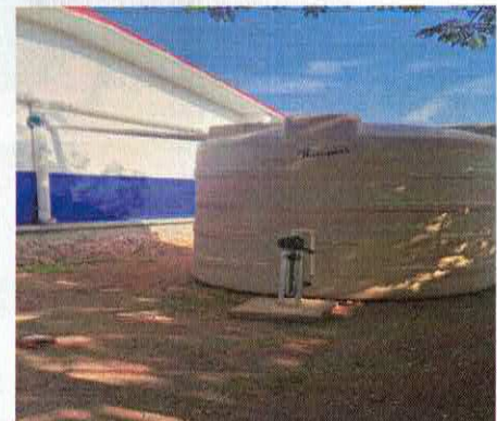
Imagen 12. Sistemas de Captación y Almacenamiento de Agua Pluvial como aprovechamiento actual de los Recursos Naturales.
