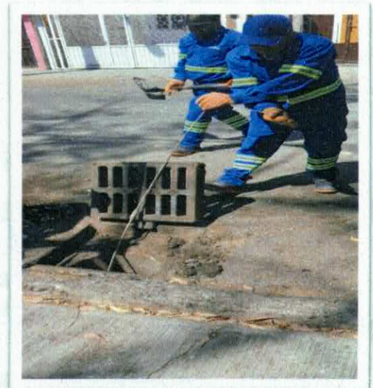
Revisión de Red de Drenaje en col Las Carmelitas, 18/03/2026
