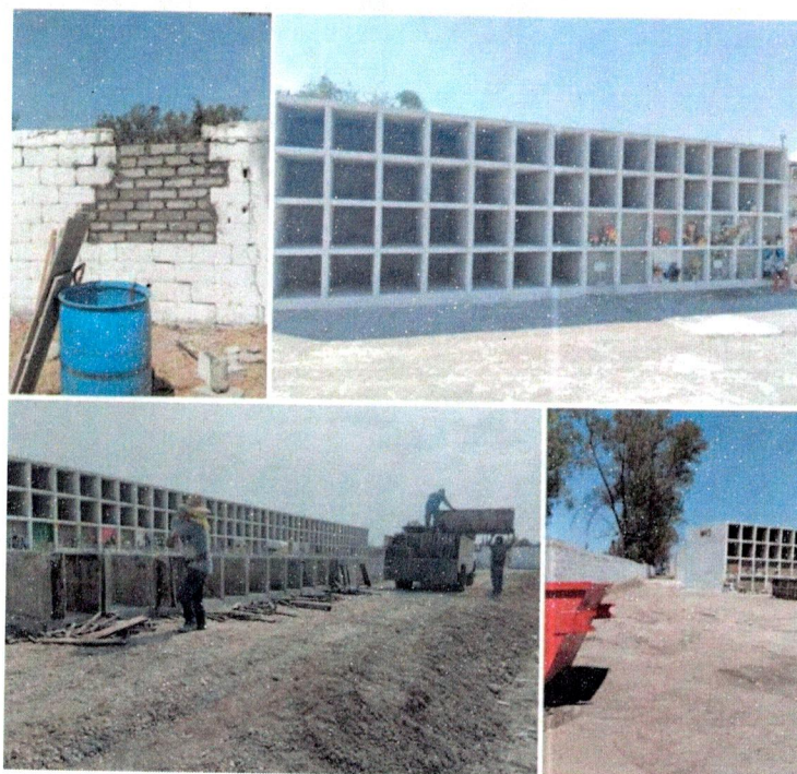
Figura 14, Construcción de gavetas en Panteón Municipal. Fuente: Informes mensuales de enero-marzo 2026 de la DIUMV
