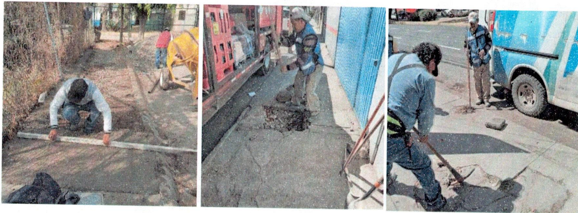
Figura 22. Concretos Mantenimiento de concretos hidráulicos (glorietas, banquetas, camellones) Fuente: Informes mensuales de enero-marzo 2026 de la DIUMV
