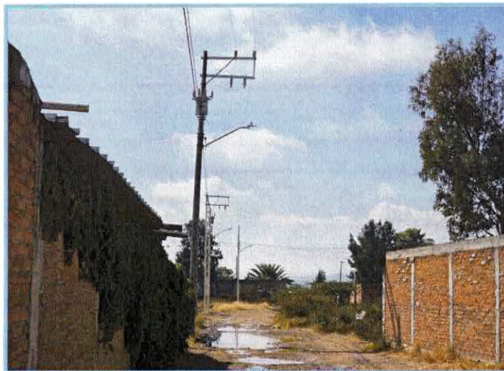
Ampliación de red de electrificación en la localidad la Calera, en calles Privada sin nombre y Av. las Torres.
