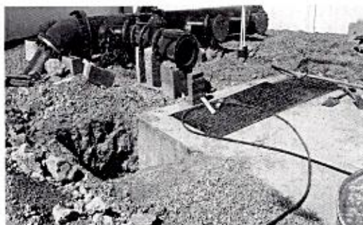
OBRA_32_JAPAMI-LS-RP-OP-2025-03 Equipamiento de Cámara ubicado en el Fraccionamiento Las Liebres.
