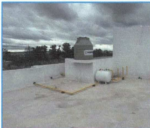
Foto 04. Instalación de tinacos y tanque estacionario en azotea. Fecha: 27.jun.25
