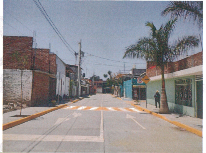
Construcción de Calle con Concreto, Colonia 5 de Septiembre, Calle Fernando Montes de Oca .
