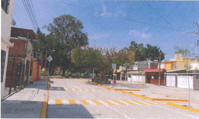
Construcción de Calle con Concreto, en la Colonia Primero de Mayo, Calle Belisario Domínguez
