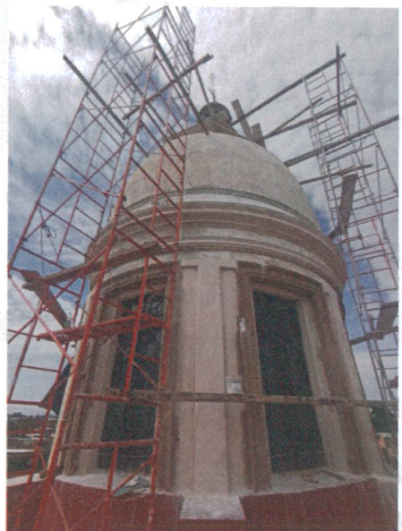
Obras de mantenimiento exterior en fachadas, azotea Y cúpula del Templo De Santiago .
