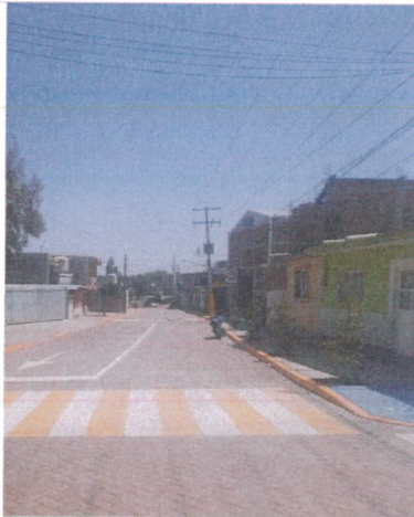
Construcción de Calle con Concreto, localidad Lo de Juárez, Calle Leyes de Reforma.
