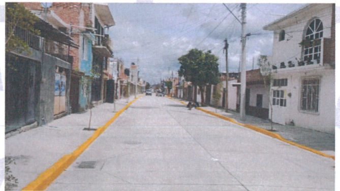
Construcción de Calle con Concreto, en la Colonia Purísima de Las Flores, Calle Girasol.
