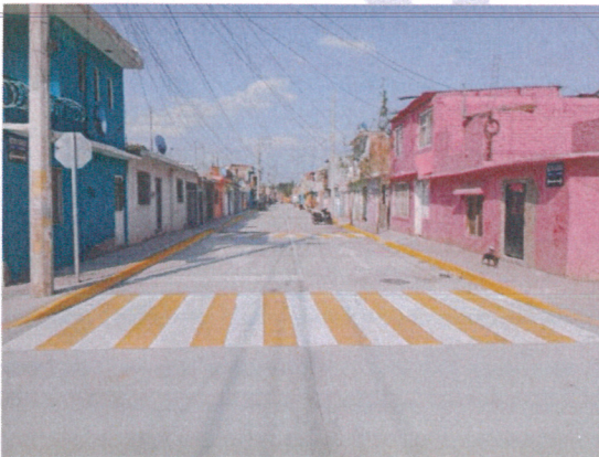
Construcción de Calle con Concreto, en la Colonia Lucio Cabañas, Calle Héctor Alvarado.
