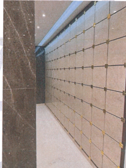
Construcción de Área de Criptas de la Parroquia de San Pedro Apóstol.
