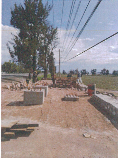
puente Peatonal en el Acceso a la Comunidad Santa Elena en el Km. 7+790 de la Carretera Federal 90.
